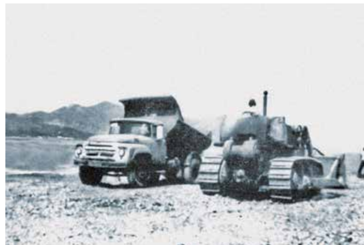
Отсыпка территории для будущей базы берегового обслуживания СП «Вьетсовпетро» Архив ГКНГ «Петровьетнам»
