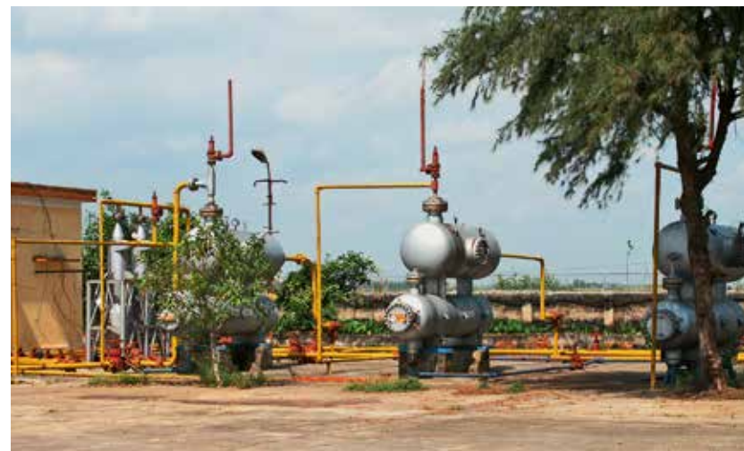
Современный вид на сепараторы газопромысла Тиенхай. 2015
